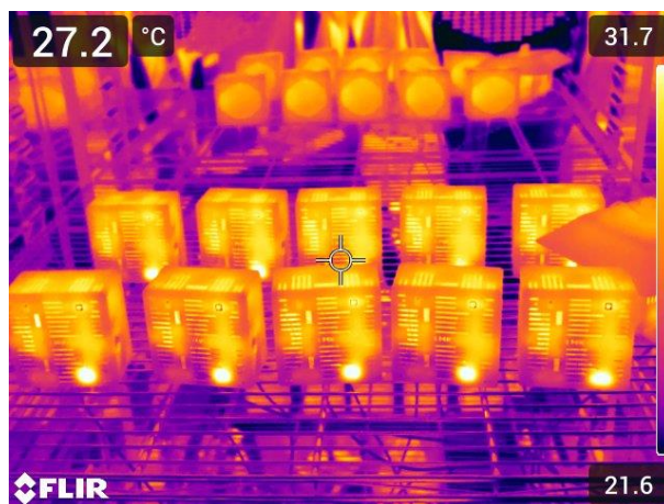
Slika 4. Slika sistema med testnim delovanjem s termovizijsko kamero
